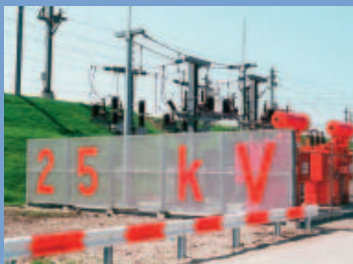
Onderstation voor 25 kV op de Maasvlakte.
